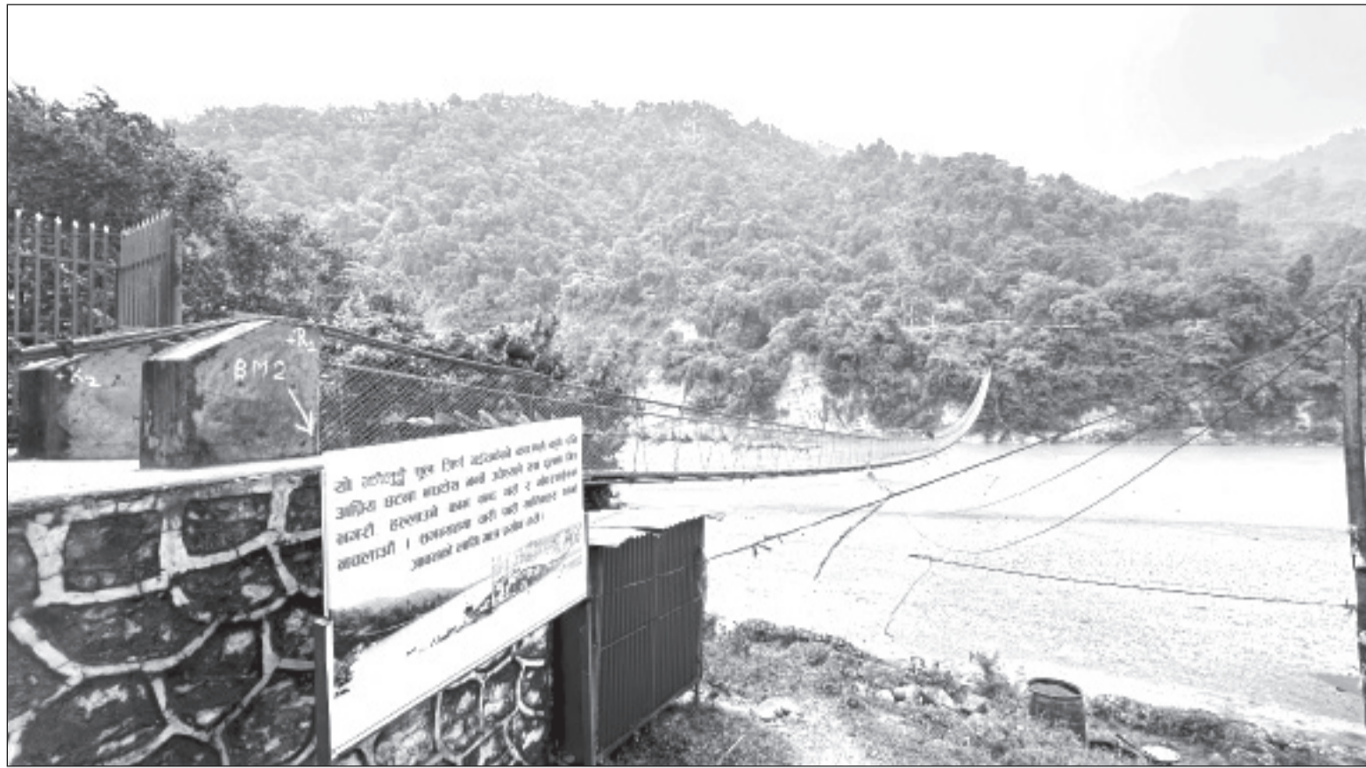
सर्लाहीको चुन्नेखेत तथा रौतहट जिल्लाको नुथरलाई जोड्न बागमती नदिमाथि बनाईएको भोलुङ्गे पुल। भोलुङ्गे पुल जिर्ण भईसकेको भन्दै पुलमा घुईचो नगर्न, नहल्लाउन र मोटरसाईडकल चलाउन रोक लगाइएको बोर्ड टाँगिएको छ।
