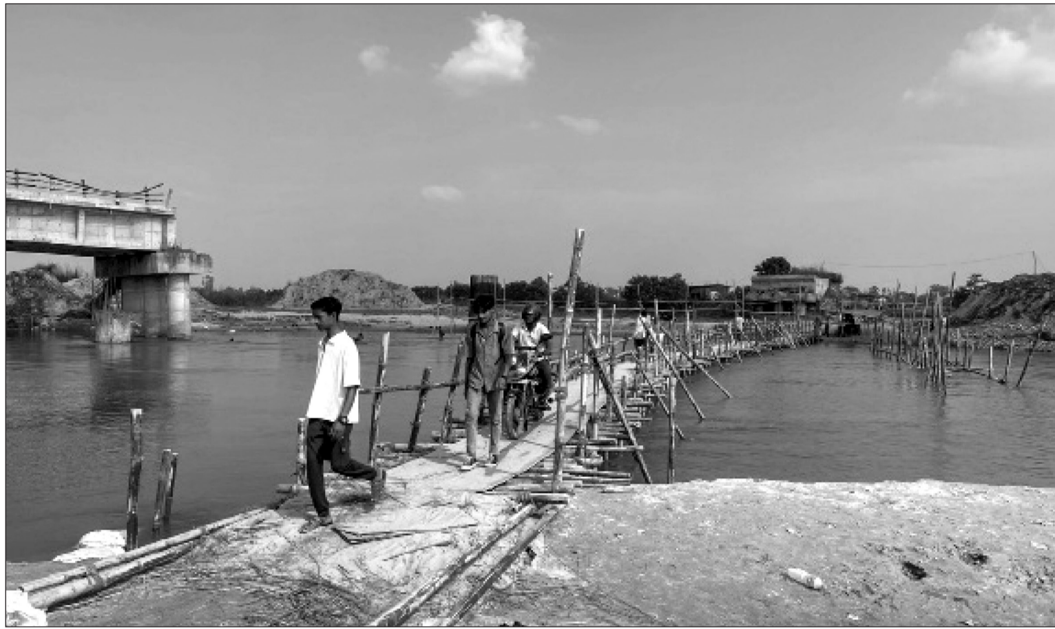
हुलाकी राजमार्ग अन्तर्गत धनुषा र सिरहालाई जोड्ने कमला नदीमा बनाइएको बाँसको अस्थायी पुलबाट नदी आवतजावत गर्दै यात्रु। नदीमा बनाइएको पक्की पुल सञ्चालनमा नआउँदै बाढीले भत्काएपछि सर्वसाधारणलाई आवतजावतमा सहजताका लागि नदीमा सिरहा नगरपालिकाले बाँसको पुल बनाएको छ।
